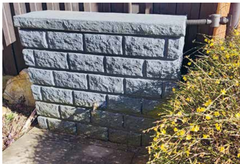
Wandtank in Form einer Mauer mit integriertem Wasserhahn für die Entnahme.
